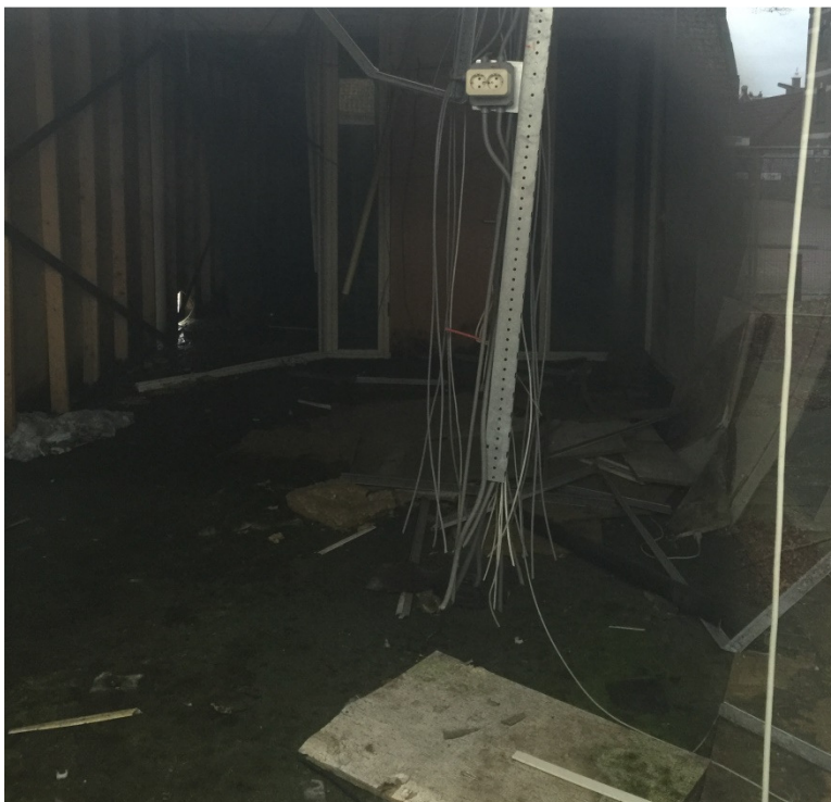
Afbeelding 40: Interieur hal 1961/5 met schade aan interieur
