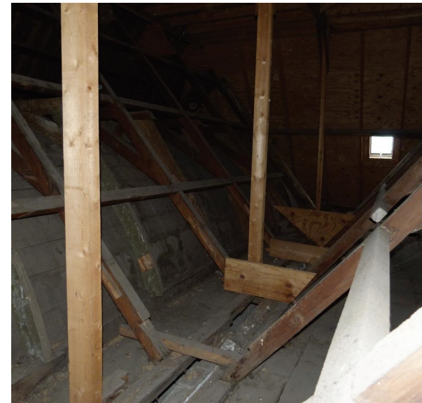
Afb. 48 De restanten van de zakgoot en Keulse goot in het midden van het oorspronkelijk rondlopende schilddak.
