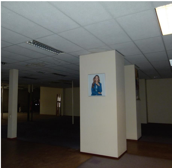
Afb. 42 De begane grond van het voormalige Oost-Indische huis is vrijwel helemaal uitgebroken.
