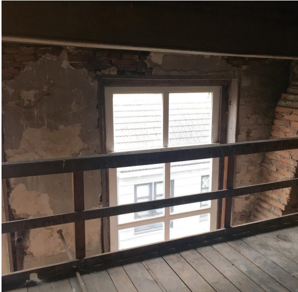
Afb. 49 De verhoogde vloer in de toneelzaal op de tweede verdieping loopt niet helemaal door tot aan de voorgevel.
