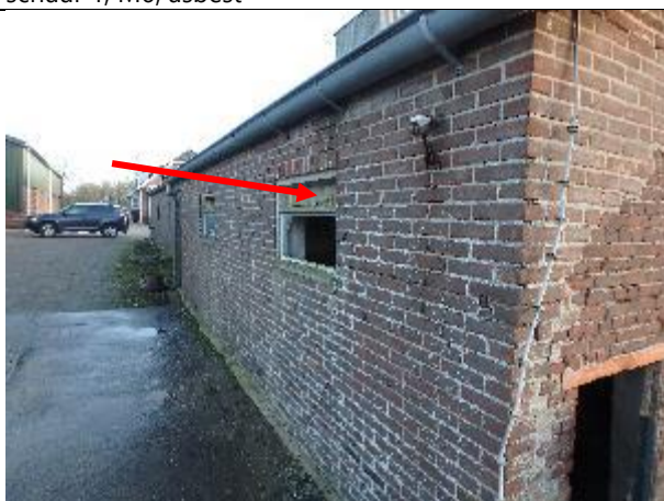
Foto nr. 21, Plaatmateriaal voorzijde in één raam schuur 1, M6, asbest
