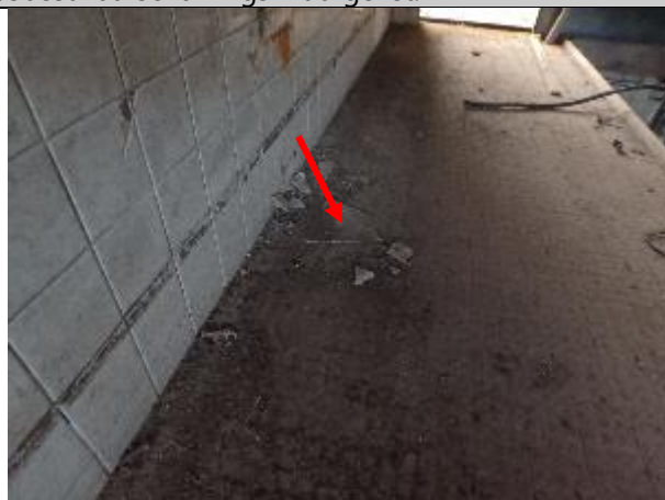
Foto nr. 24, Restanten op de vloer, identiek aan M1, asbest
