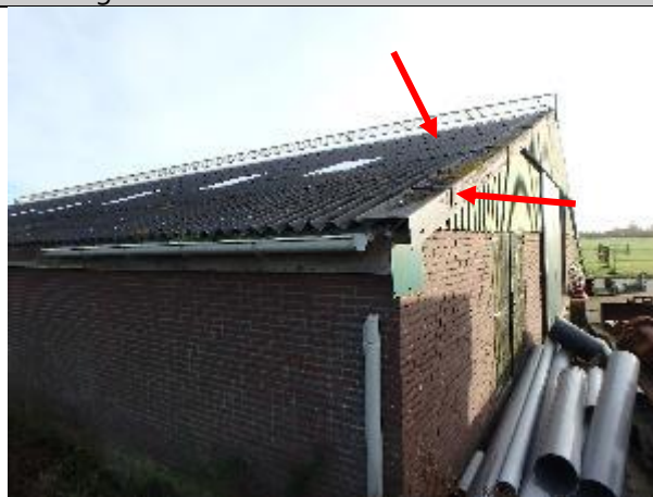
Foto nr. 4, Golfplaat en hulpstukken van schuur 2, M1, asbest
