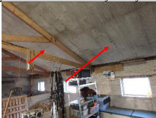
Foto nr. 6, Plaatmateriaal tegen binnenzijde stal/ schuur 1, M2, asbest
