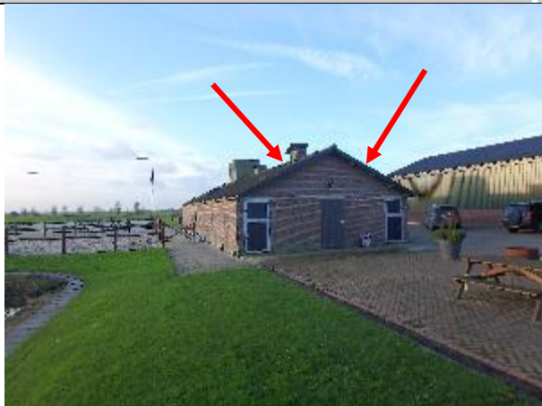
Foto nr. 1, Golfplaat van schuur 1, M1, asbest
