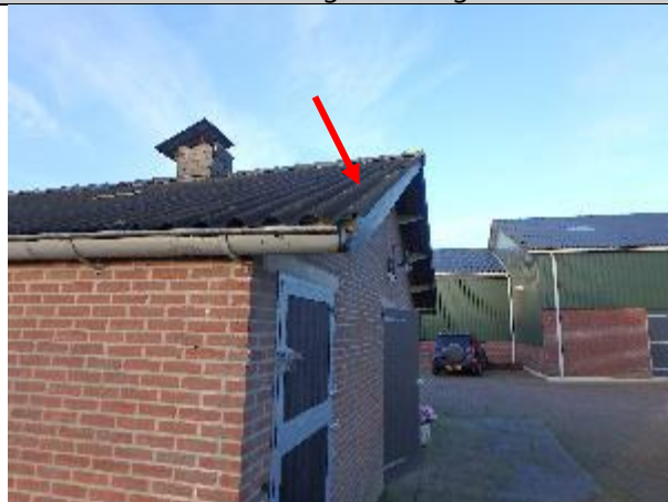
Foto nr. 2, Golfplaat van schuur 1, M1, asbest
