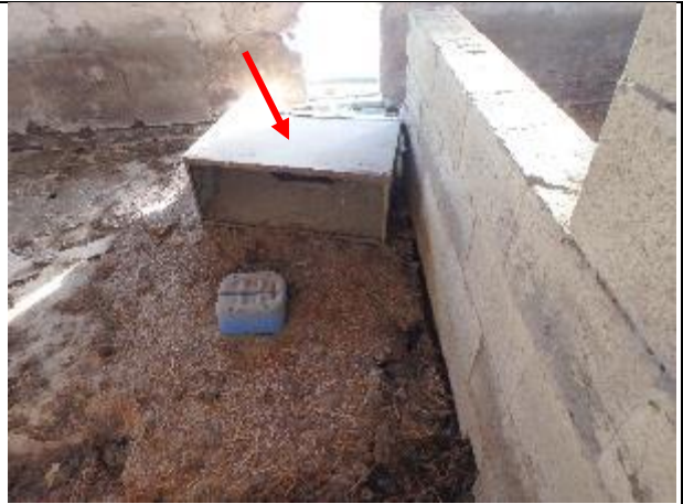
Foto nr. 18, Vlakke platen als kast en voederbakken schuur 1, M5, asbest
