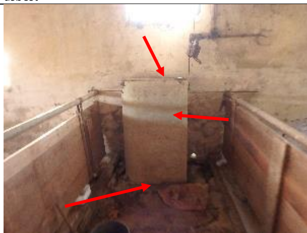
Foto nr. 16, Vlakke platen als kast en voederbakken schuur 1, M5, asbest
