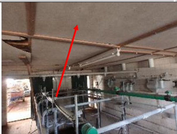
Foto nr. 9, Plaatmateriaal als plafondbeplating schuur 2, M2, asbest
