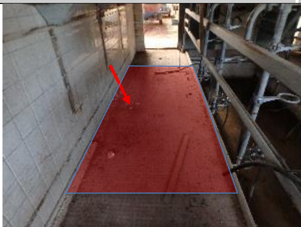
Foto nr. 23, Restanten op de vloer, identiek aan M1, asbest
