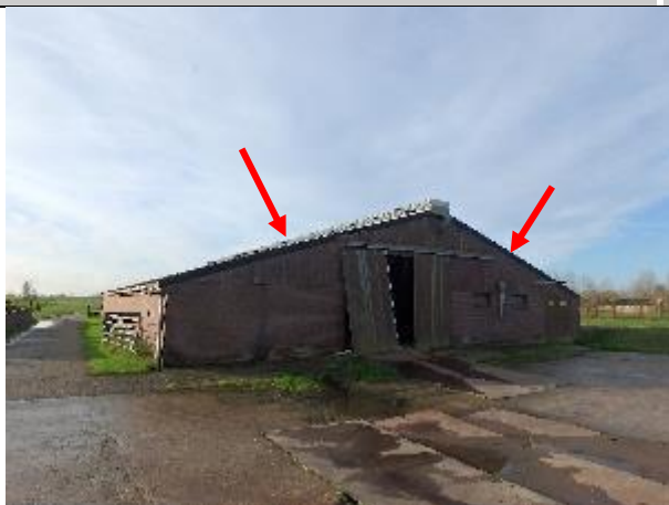
Foto nr. 3, Golfplaat en hulpstukken van schuur 2 , M1, asbest
