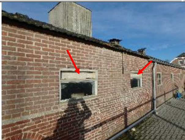
Foto nr. 19, Plaatmateriaal achterzijde in twee ramen schuur 1, M6, asbest
