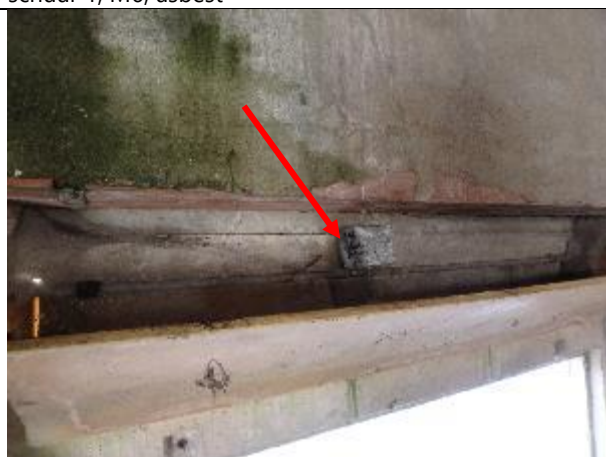
Foto nr. 22, Plaatmateriaal voorzijde in één raam schuur 1, M6, asbest
