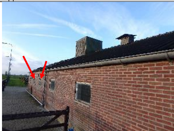
Foto nr. 20, Plaatmateriaal achterzijde in twee ramen schuur 1, M6, asbest
