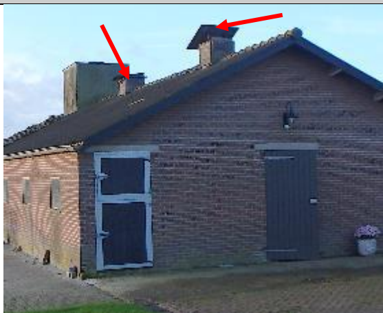
Foto nr. 7, Plaatmateriaal op de dak doorvoeren van schuur 1, M2, asbest
