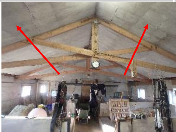
Foto nr. 5, Plaatmateriaal tegen binnenzijde stal/ schuur 1, M2, asbest
