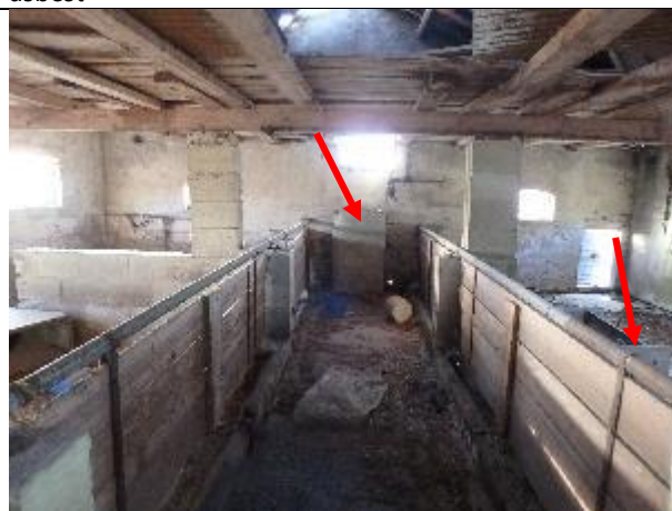
Foto nr. 15, Vlakke platen als kast en voederbakken schuur 1, M5, asbest
