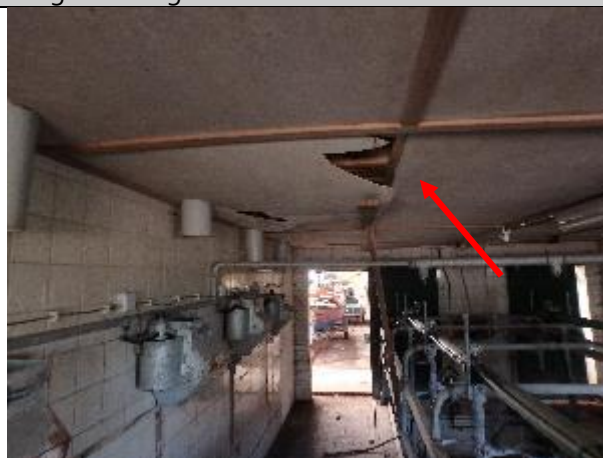
Foto nr. 10, Plaatmateriaal als plafondbeplating schuur 2, M2, asbest
