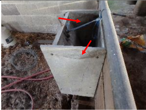
Foto nr. 17, Vlakke platen als kast en voederbakken schuur 1, M5, asbest
