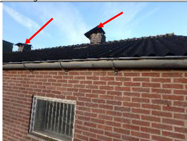
Foto nr. 8, Plaatmateriaal op de dak doorvoeren van schuur 1, M2, asbest
