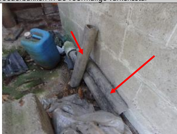
Foto nr. 14, Restanten van buizen in schuur 1, M4, asbest
