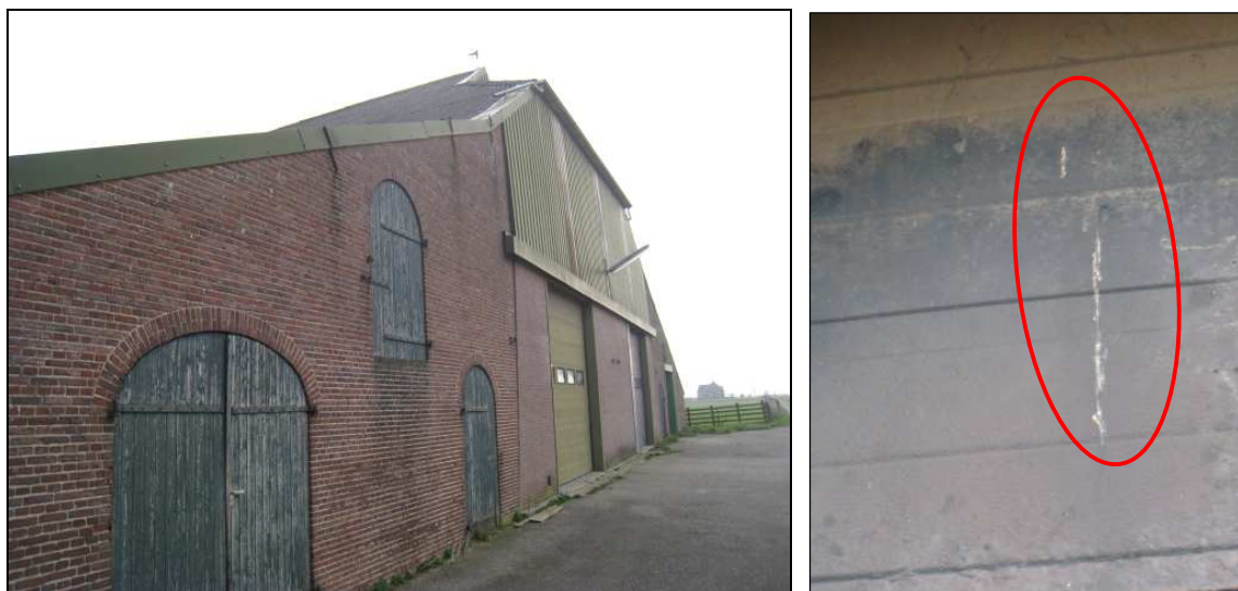
Figuur 7. Spoor van een uil op de bebouwing van de Oude Steenfabriek te Montfoort.
