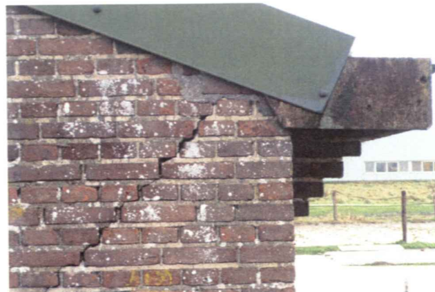
foto 10 westgevel rechtertravee zettingsscheur.
