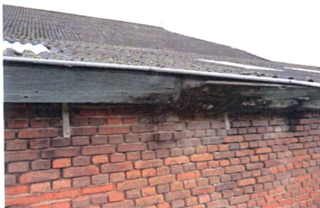
foto 11 zuidgevel, gootlijst, uitgespoeld metselwerk.
