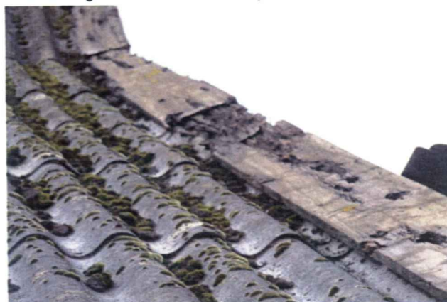
foto 12 oostgevel ingerot waterbord.
