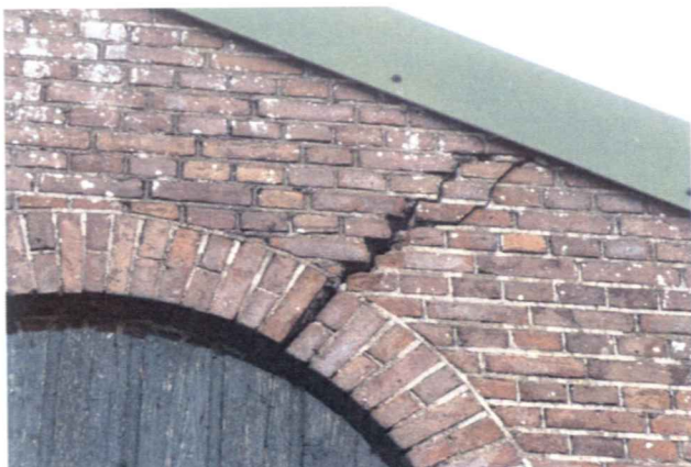
foto 9 westgevel rechtertravee zettingsscheuren.
