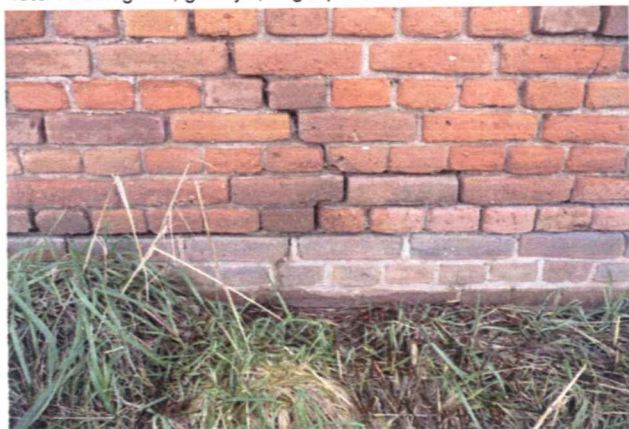
foto 13 zuidgevel scheurvorming, uitgespoeld metselwerk.
