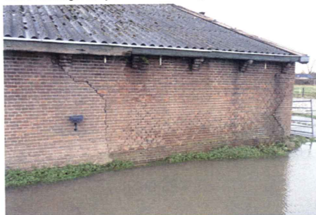
foto 16 zuidgevel, scheurvorming, water tegen gevel.
