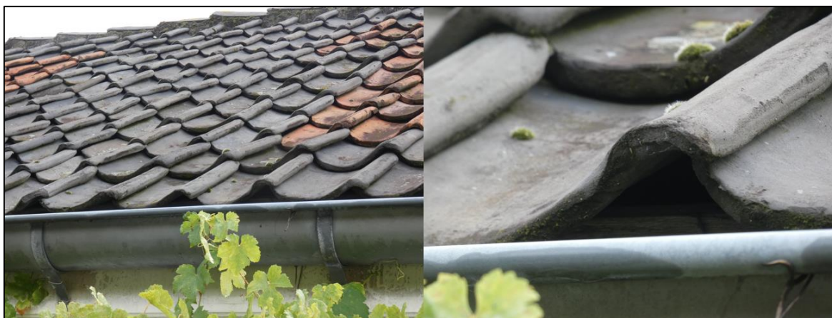
Figuur 3.1 Openingen onder de onderste dakrand geschikt als nestlocatie voor de huismus.
