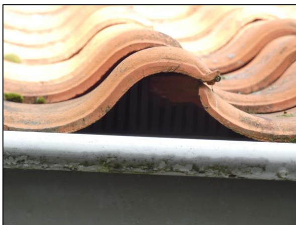
Figuur 3.2 Vogelschroot bij de onderste rij dakpannen van de bebouwing aan Jacob Barneveldstraat.
