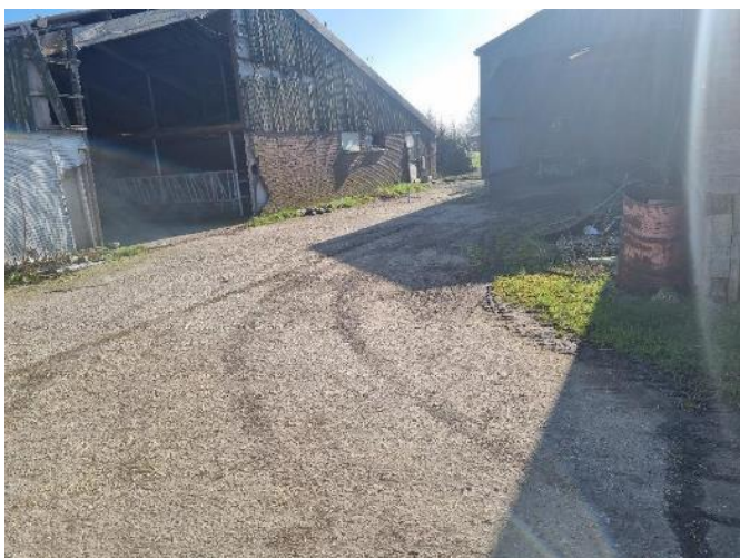
Foto 2: Erf Nieuwe Zandweg 23 met asbestverdachte opstallen
