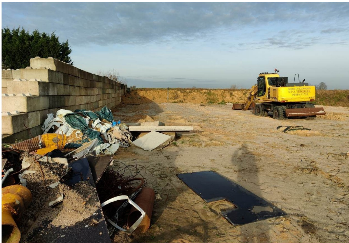
Foto 1: overzicht onderzoekslocatie, uitzicht op grondwal met zintuiglijke verkleuring
