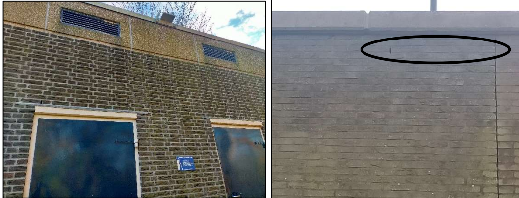
Figuur 2.7 Gebouwen met potentiële vleermuisverblijfplaatsen. Links te slopen gebouw met ventilatieroosters en rechts open stootvoegen in de oude opslagkelder.
