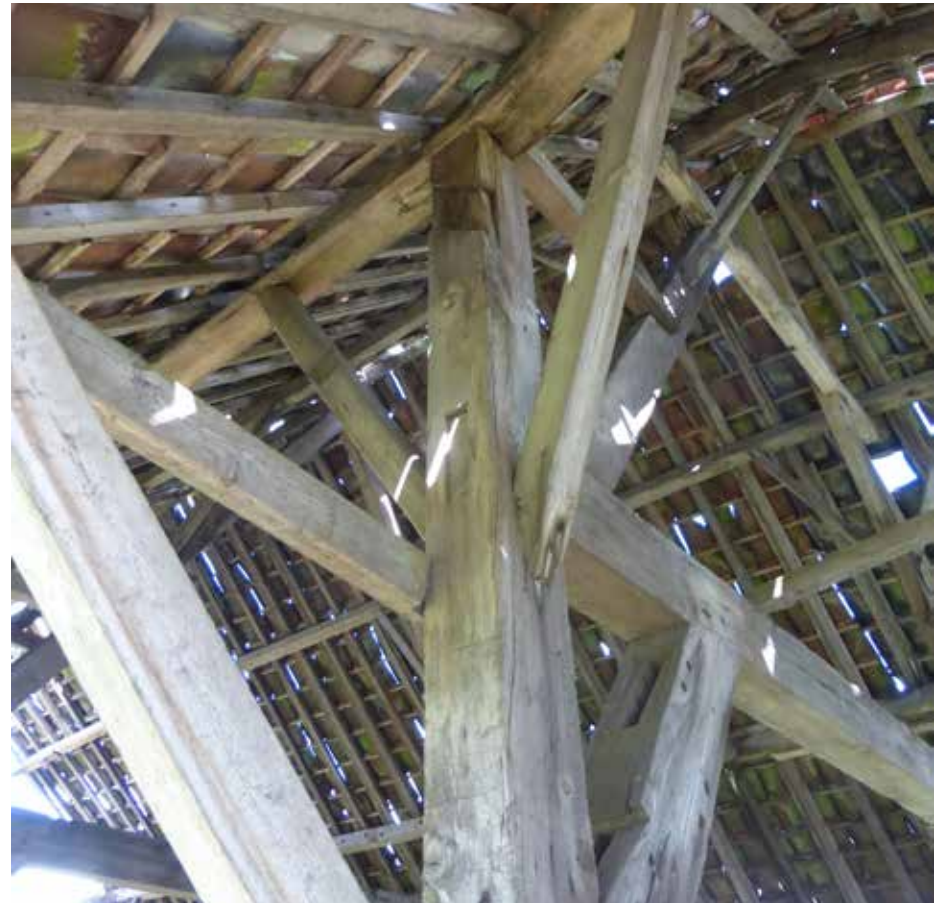
afbeelding 6. De gebintconstructie toont meerdere onbenutte pengaten en inkepingen.
