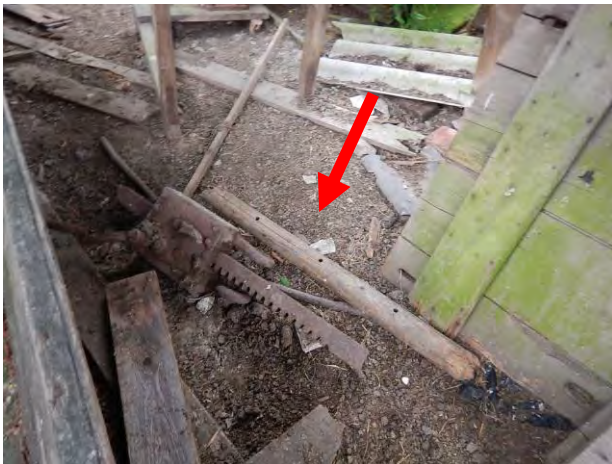
Bron 1 golfplaat restanten (2)
