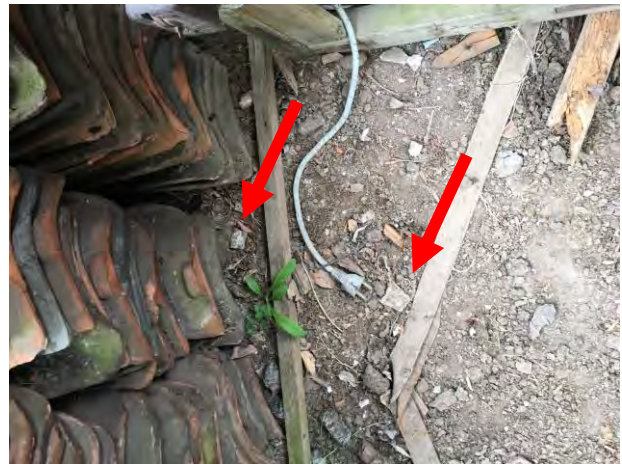
Bron 1 golfplaat restanten (3)
