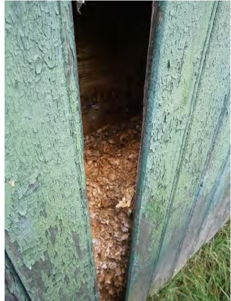
Kraaldelen met isolatiemateriaal
