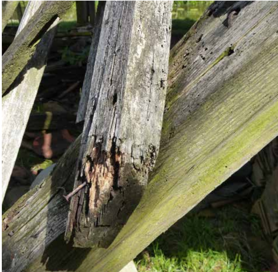
afbeelding 13. Deze spoor is aan de onderzijde afgeschuind en ligt met de brede zijde op de randbalk van de ingestorte gebintconstructie tussen de voormalige paardenstal en de droogschuur. Uit de spoor steekt een draadnagel.
