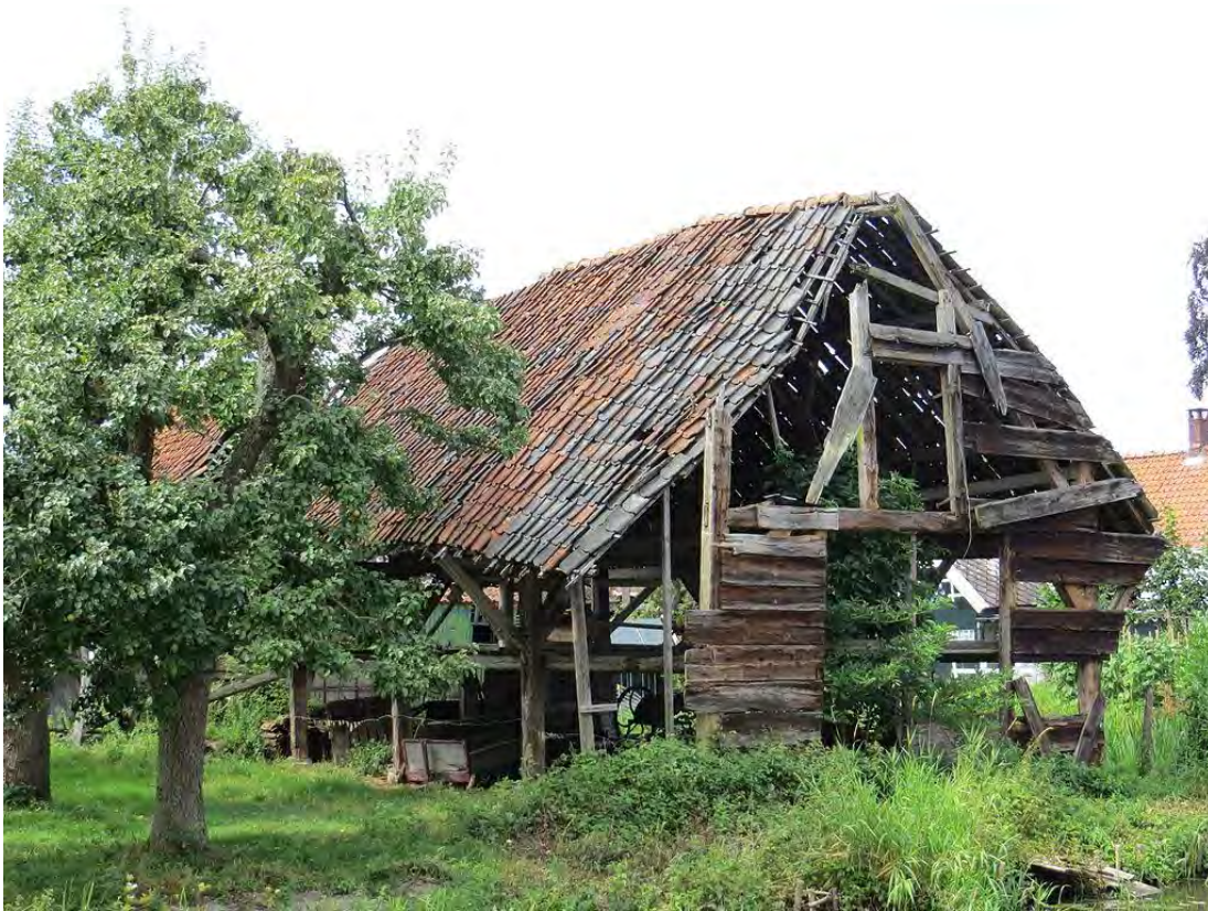
Reeds voor 2016 was het middendeel (achter de boom) ingestort...
