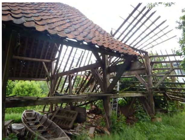
Droogschuur is in een vervallen staat en deels ingestort
