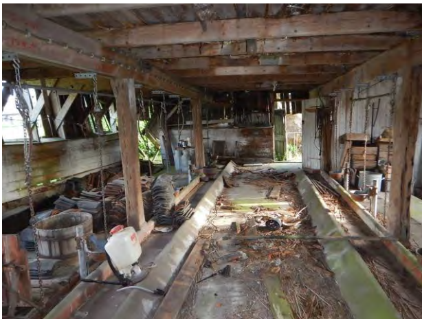
Koeienstal is in een vervallen staat
