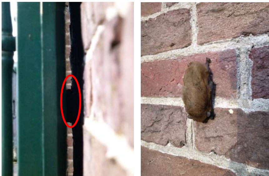
De gewone dwergvleermuis (levend) achter één van de luiken aan de linkerzijde van het woonhuis. Links een foto van de vleermuis (rood omcirkeld) achter het luik en rechts een close-up van de vleermuis.
