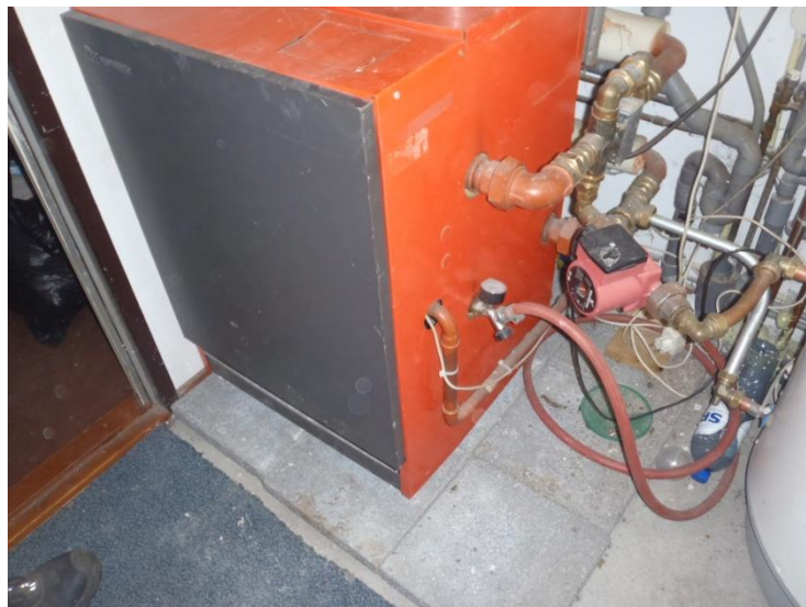
Foto 3: asbestvrije cv-ketel (M1), cv-ruimte
