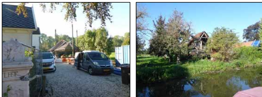
Figuur 2.12 Links; de oprit van de boerderij aan de Liefhovendijk 2 met rechtsachter de half ingestorte hooiberg en schuur. Rechts; de half ingestorte schuur in het zuidelijke deel van het erf (foto E.A.M. de Boer, 27 september 2018).
