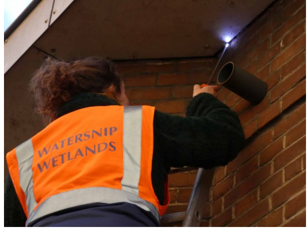
Figuur 14 Inspectie Trespaplaten met endoscoop
