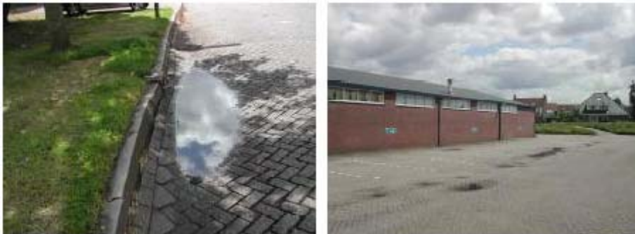
Verzakkingen en plasvorming op openbare weg en bij de overgang met privaat gebied
