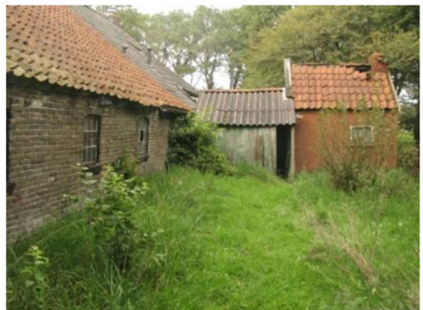
Foto 5: Vervallen bakhuisje met bijgebouwtje.
