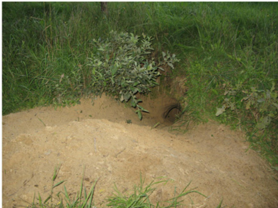
Foto 7: Een van de dassenpijpen in het sloottalud.
