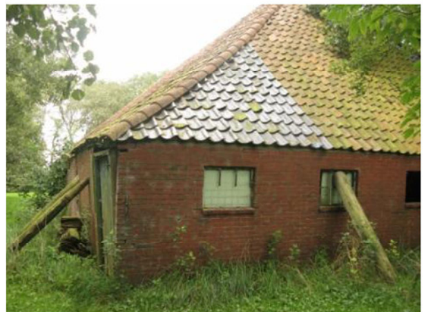
Foto 4: Hoek van de vervallen schuur
