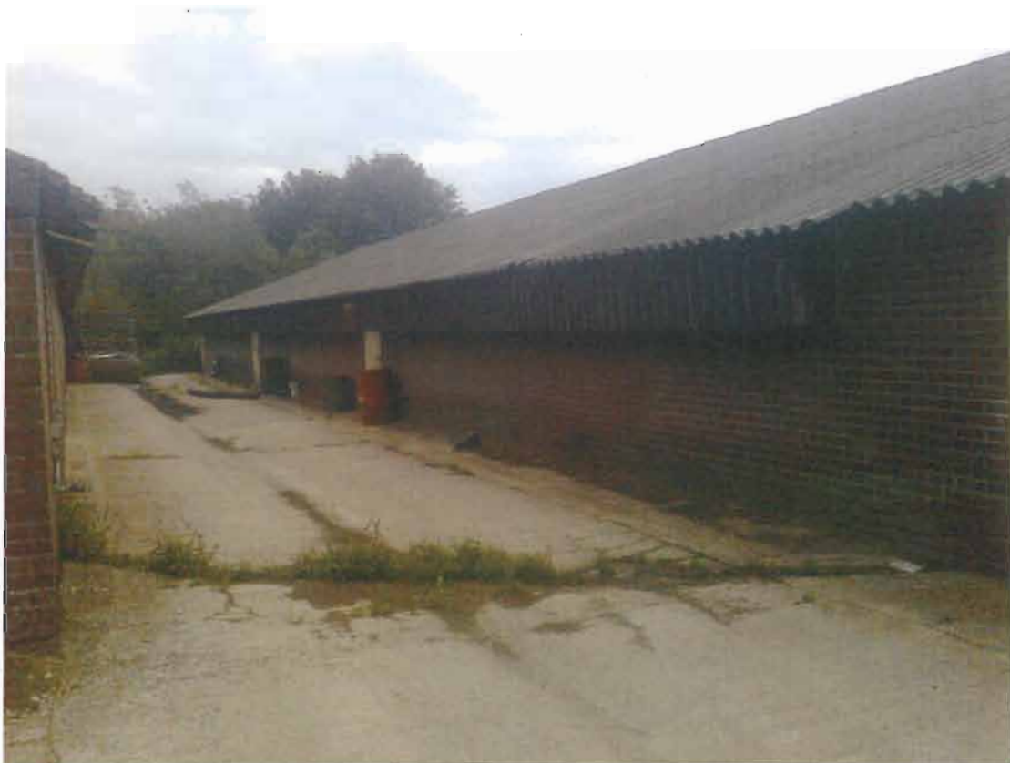
foto 3: asbestverdachte materialen aan varkensstal (27 juni 2011)
