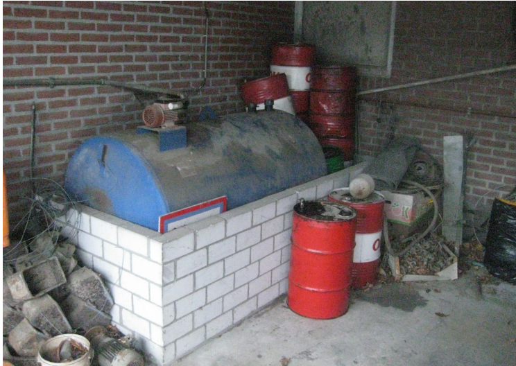
Foto 4: bovengrondse dieseltank (1.200 liter)
