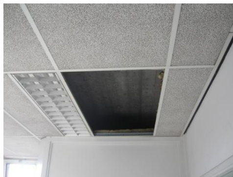
Foto 12. De ruimtes boven het systeemplafond in de kantoorunit vormen een potentiële verblijfplaats voor vleermuizen.
