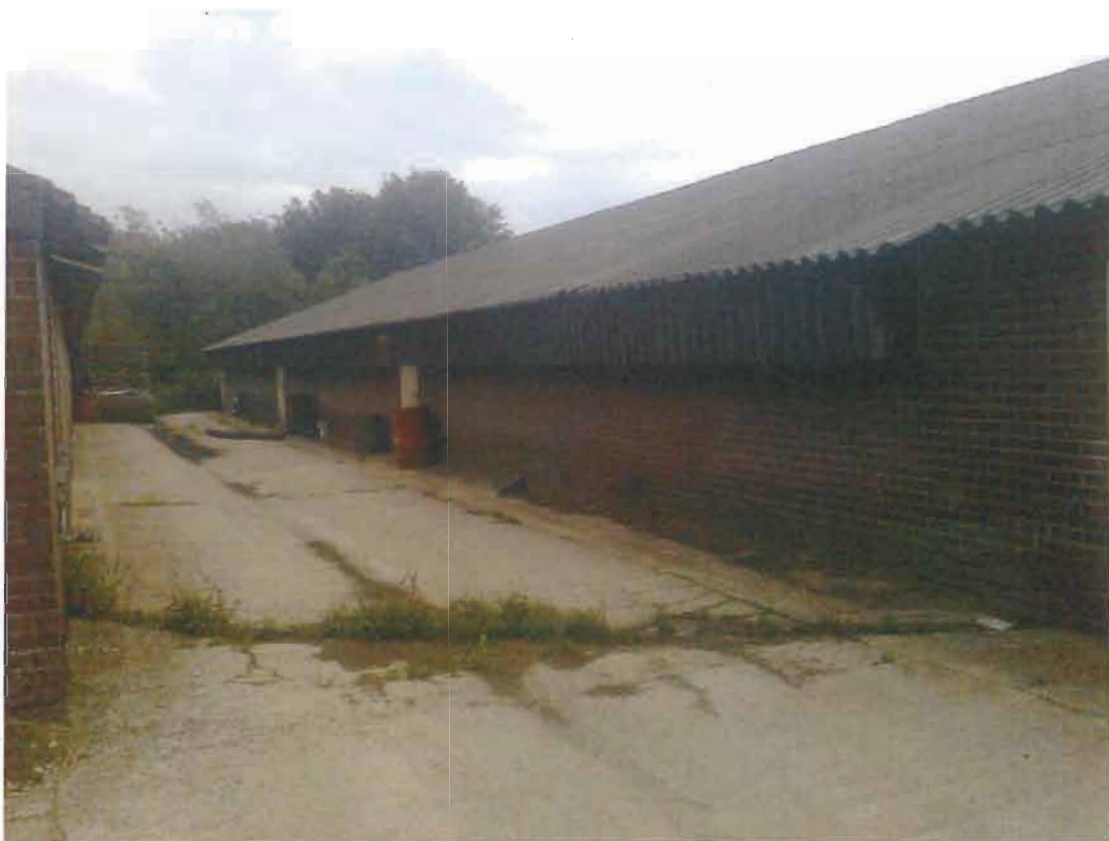
foto 3: asbestverdachte materialen aan varkensstal (27 juni 2011)
