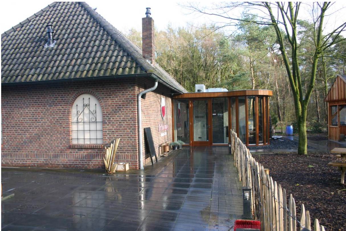
Figuur 7. Het gebouw is ongeschikt voor vleermuizen.
