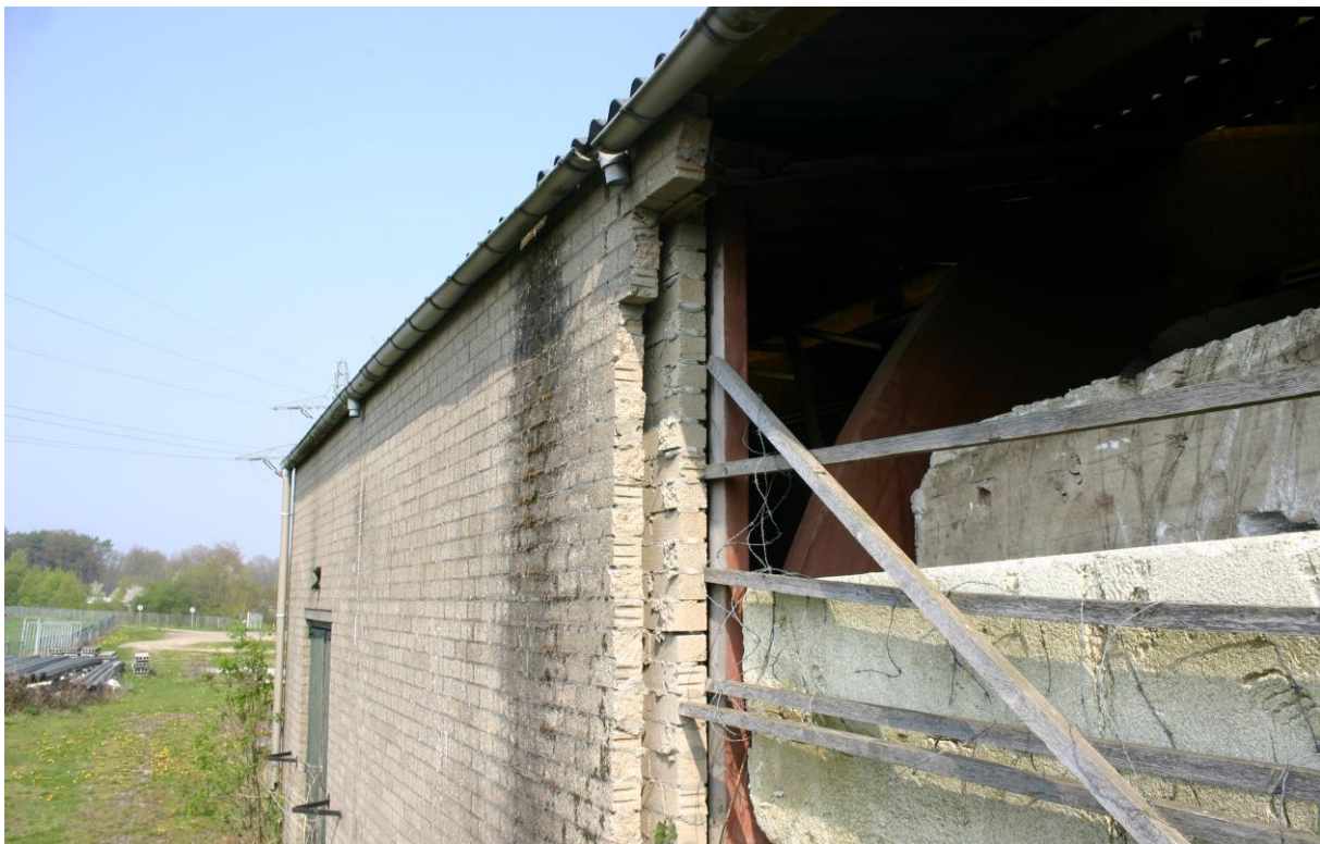
Figuur 4.5.3. Aan de westzijde van de manege is de muur gedeeltelijk ingestort. Vleermuizen en kleine, grondgebonden zoogdieren hebben hier toegang tot de spouw.
