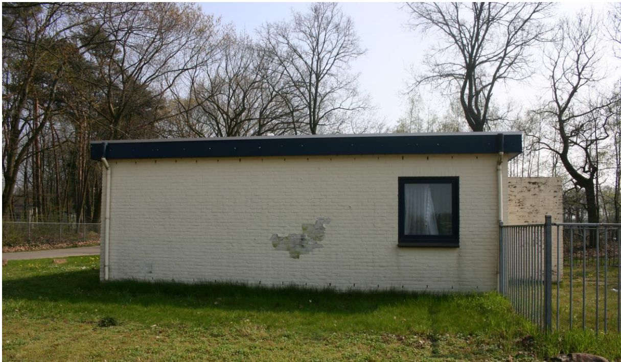
Figuur 4.5.1. De voormalige beheerderswoning heeft vele open stootvoegen, waardoor de spouw toegankelijk is voor vleermuizen en kleine, grondgebonden zoogdieren.
