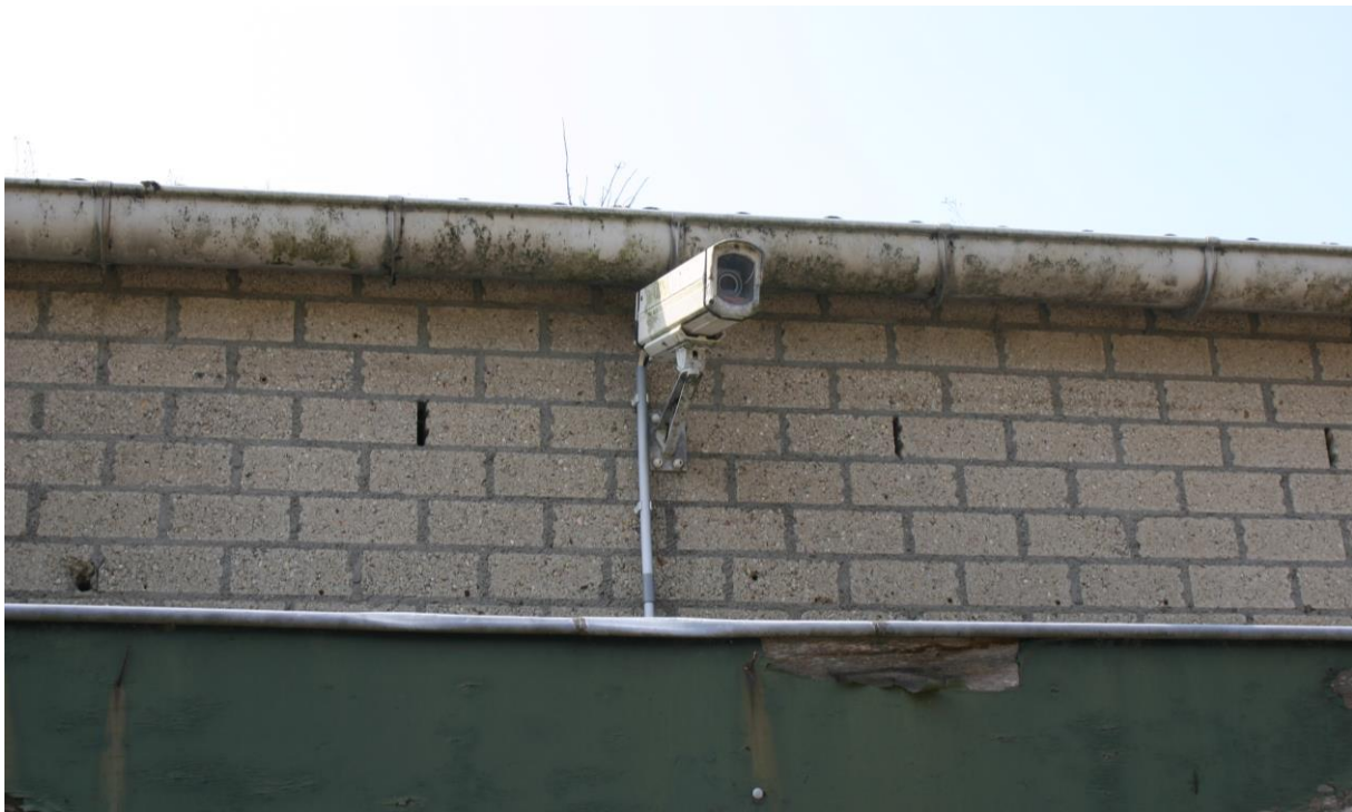
Figuur 4.5.2. In de voormalige manege zijn diverse open stootvoegen aanwezig.
