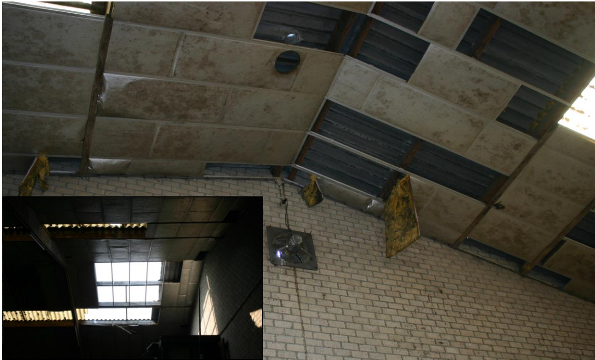
Figuur 4.5.4. In het dak van de manege ontbreken veel stukken isolatiemateriaal. Op enkele plekken is het dak zelfs volledig open (zie inzet).
