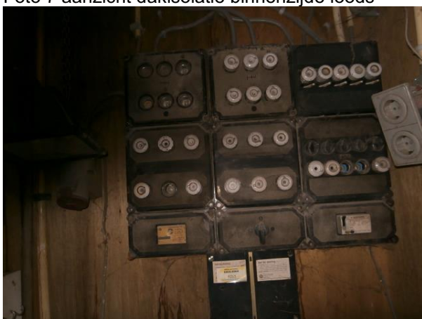
Foto 9 meterkast loods op houten plaat
