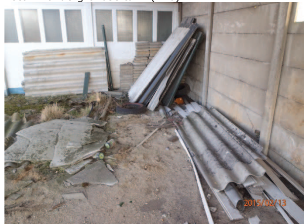
Foto 4: Asbest op verhardingslaag boring A9 (14b).
