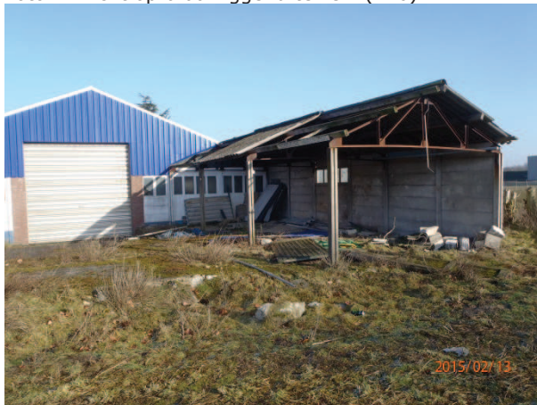
Foto 3: Vervallen gedeelte bedrijfspand (14b).
