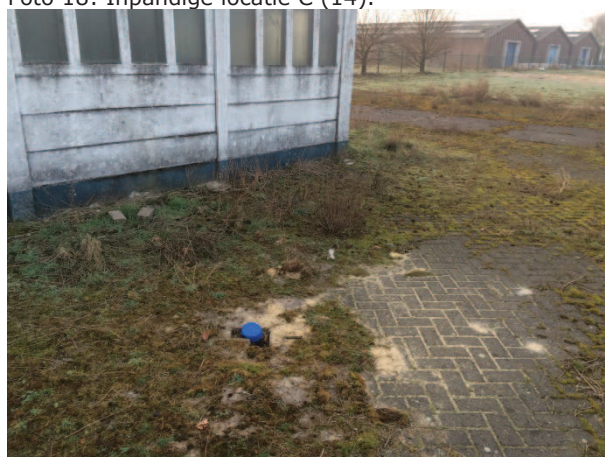
Foto 20: Peilbuis A12 locatie A (14b).
