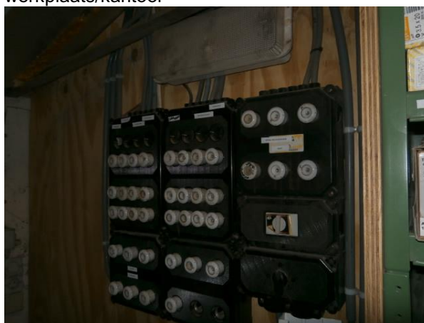
Foto 16 meterkast werkplaats/kantoor op houten plaat
