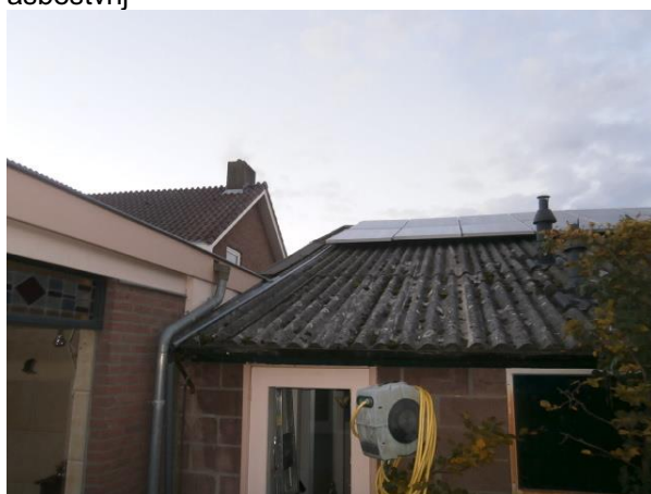
Foto 24 één asbesthoudende windveer voorgevel werkplaats/kantoor
