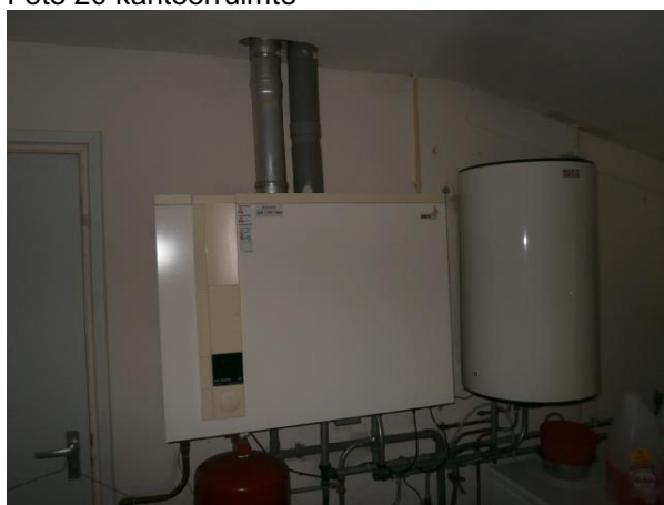
Foto 22 aanzicht cv-ketel en boiler in werkplaats/kantoor, conform opgave opdrachtgever geplaatst na 1994 en als zodanig asbestvrij
