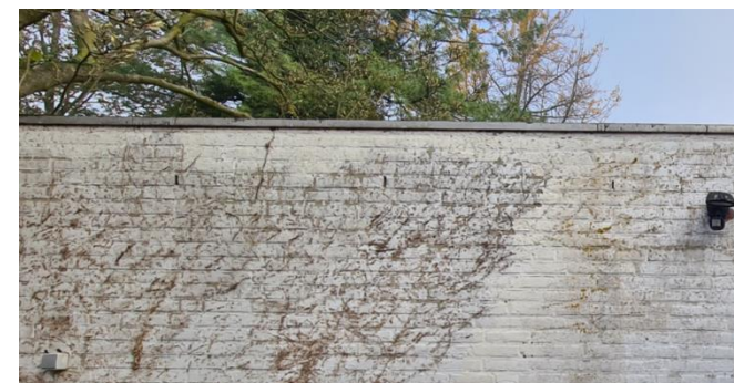
Figuur 12: Open stootvoegen in de noordwestgevel van de dierenartspraktijk.
