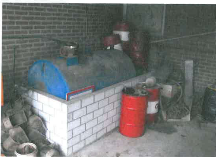
Foto 4: bovengrondse dieseltank (1.200 liter)
