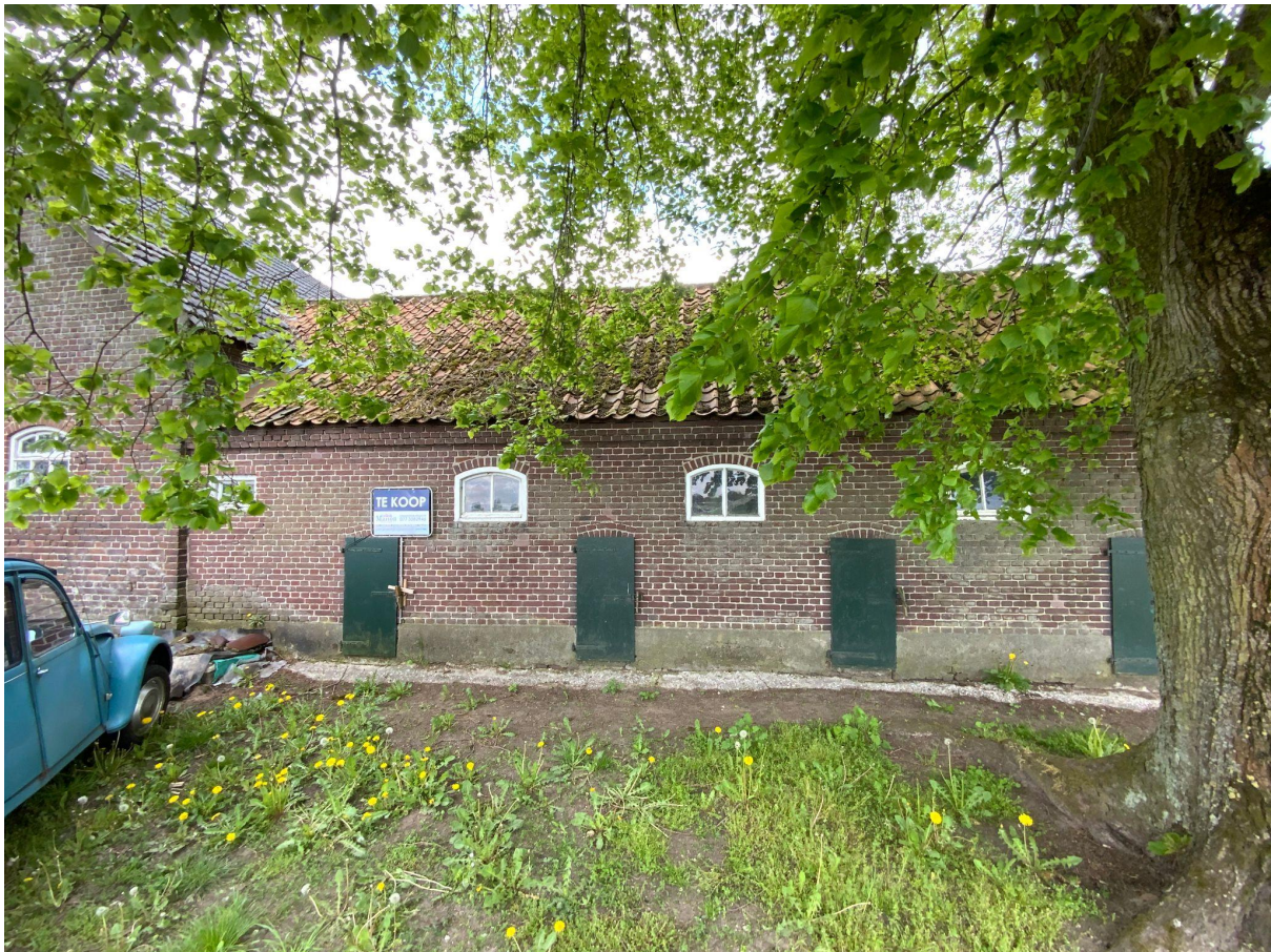
Foto 1: Verticale voeg tussen voorgevel en zijgevel varkensstal
