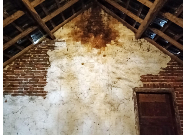
Vochtschade muur koeienstal en woonhuis
