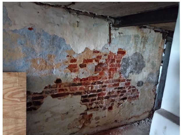
Lekkage schade muur varkensstal
