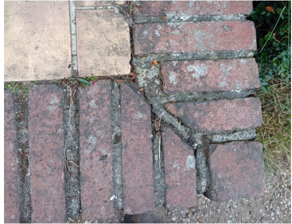
scheur in talud
