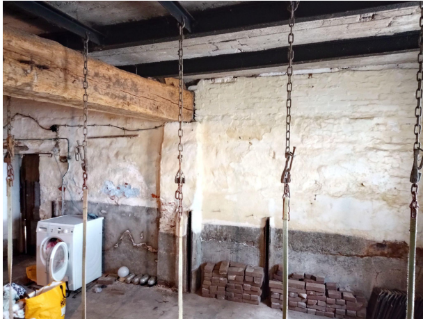
Vochtschade muur koeienstal en varkensstal
