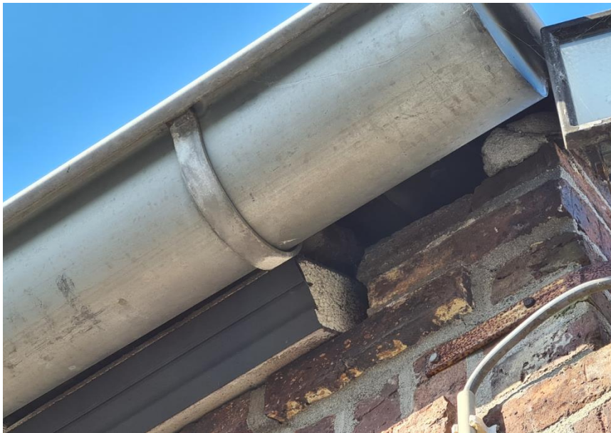
Figuur 3: Kieren bij de dakrand
