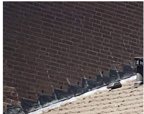
Afbeelding 35. Open stootvoegen, indicatie voor vleermuizen
