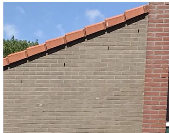
Afbeelding 37. Open stootvoegen, indicatie voor vleermuizen
