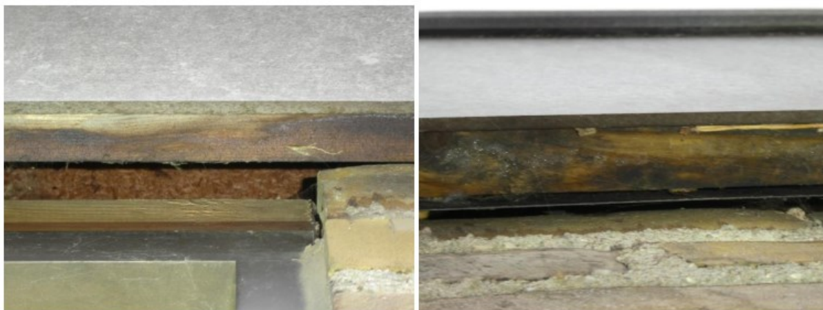
Afbeelding 10 en 11: Openingen naar mogelijke verblijfplaatsen van vleermuizen aangetroffen nabij kozijnen en ruimte tussen de overstek en muren. Bron: BNL advies, datum: 24-02-2023
