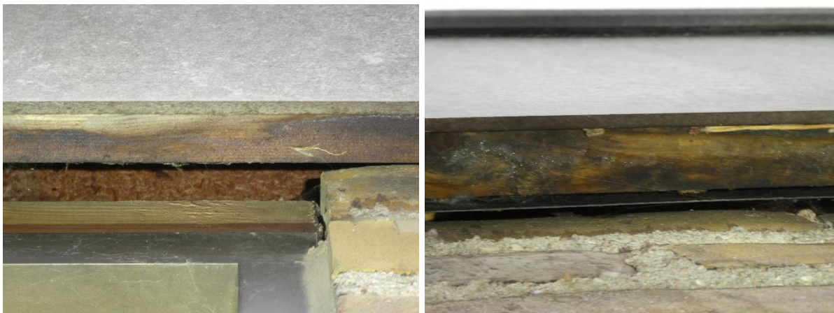
Afbeelding 10 en 11: Openingen naar mogelijke verblijfplaatsen van vleermuizen aangetroffen nabij kozijnen en ruimte tussen de overstek en muren. Bron: BNL advies, datum: 24-02-2023
