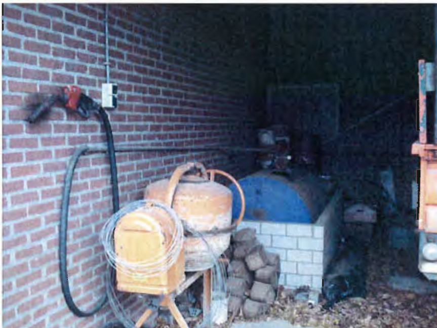
Bovengrondse dieseltank met afleverpunt
