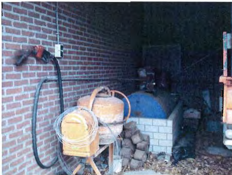
Bovengrondse dieseltank met afleverpunt
