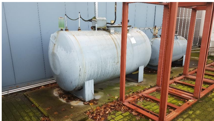
foto 4: bovengrondse olietanks directe omgeving (10 december 2019)
