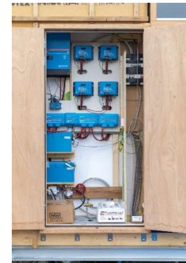
Installatiekast energiesysteem Marjolein in t klein
