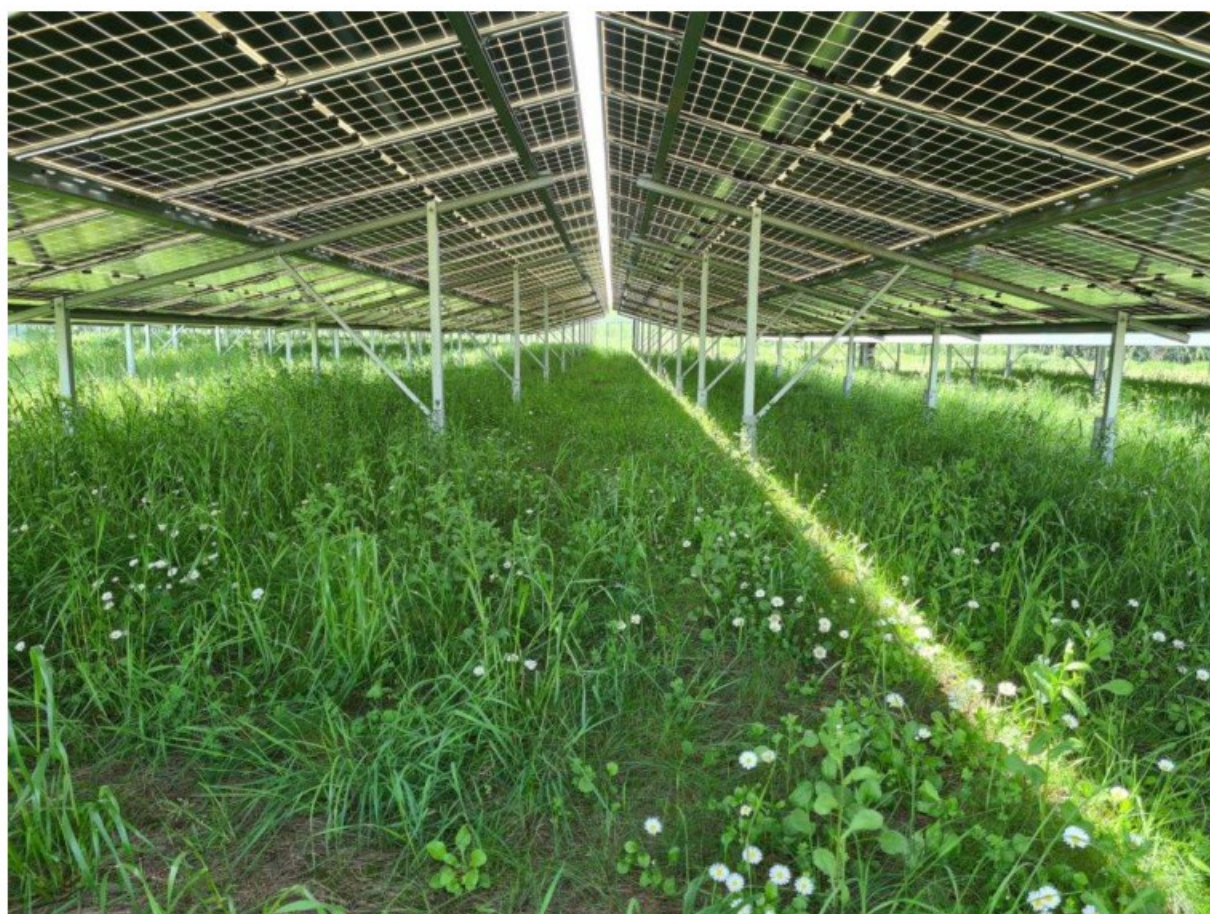
Onder bifaciale panelen is ook bij een oost-westopstelling nog sprake van voldoende lichttoetreding onder de panelen om hier een gesloten vegetatie te ontwikkelen, zoals dit voorbeeld uit Roosendaal laat zien.
