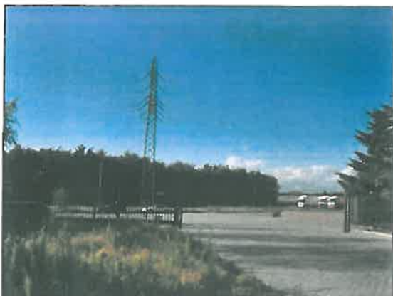
Afbeelding 13. De hoogspanningsmast op het terrein
