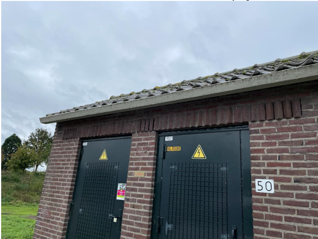
Foto 19: het transformatorhuisje heeft openstootvoegen waardoor deze geschikt is voor vleermuizen.
