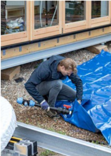
Opvang en hergebruik regenwater
