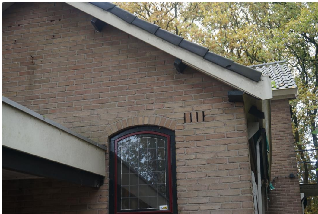
Figuur 6.6. Open stootvoeg aan de westgevel van de bestaande woning.
