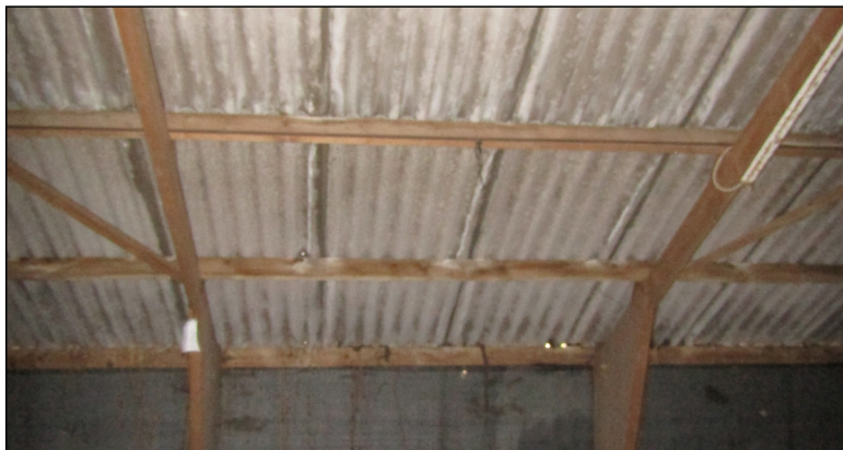
Figuur: de meest oostelijke schuur heeft enkel een asbest dak, zonder isolatieplaten aan de binnenkant.
