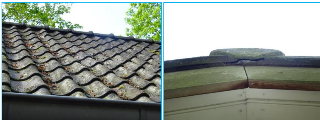
Foto's: dak niet toegankelijk voor vleermuizen. Tevens geen geschikte opening bij de nokpan.
