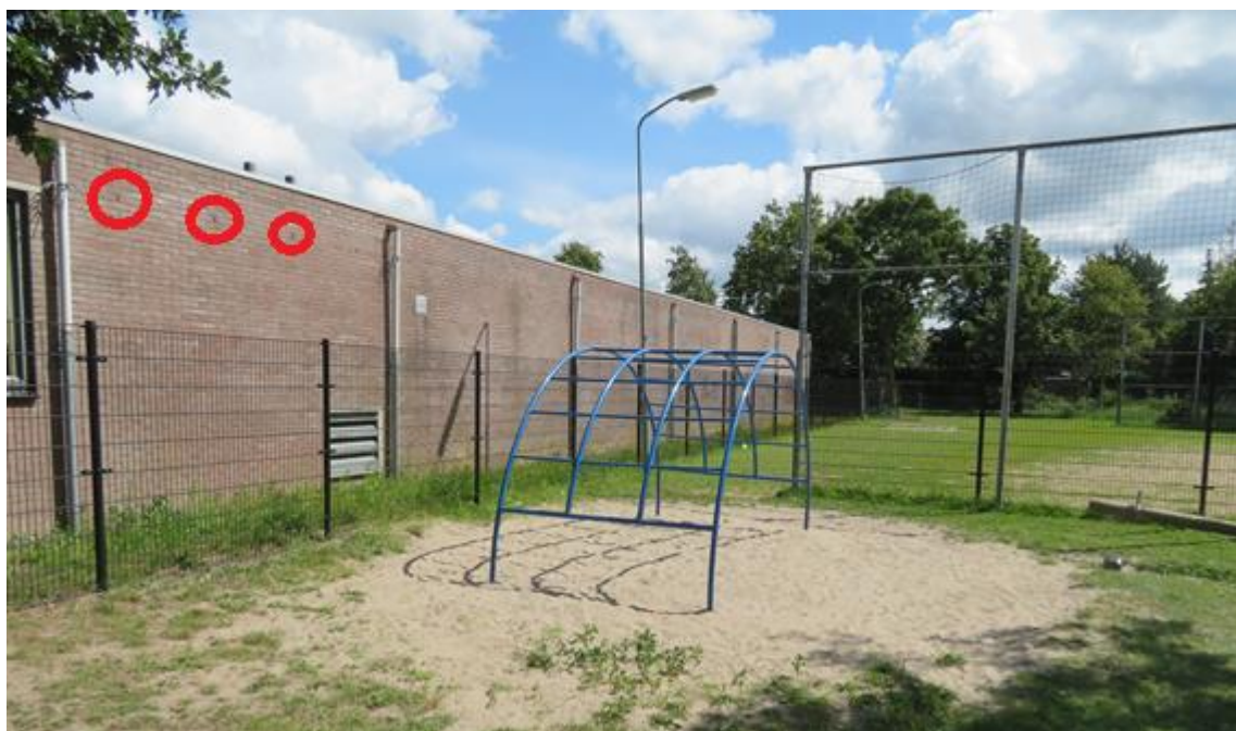
Figuur 5: Langs het gehele gebouw, met uitzondering van de voorgevel, zitten open stootvoegen in de muren.
