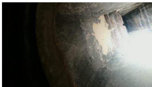
Kanaal gemetseld eindpijp gresbuis
