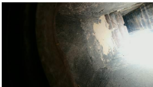
Kanaal gemetseld eindpijp gresbuis
