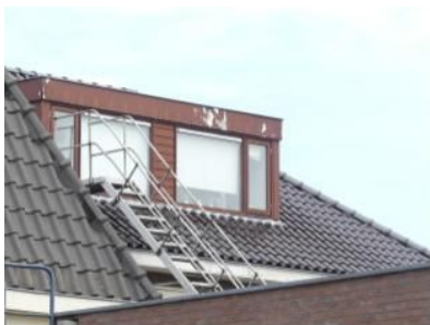
Foto: De staat van de dakkapel aan de achterzijde oogt vervallen. Dit suggereert mogelijkheden voor scheuren en kieren waar gierzwaluwen en vleermuis gebruik van kunnen maken.
