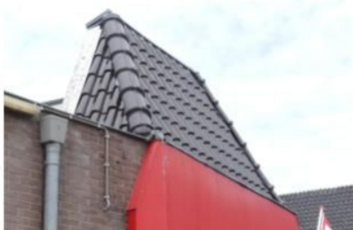
Foto: De dakpannen op het hoekdak aan de voorzijde sluiten perfect aan. Geen dakpan ligt er scheef, geen opening te zien dat interessant zou kunnen zijn voor fauna.
