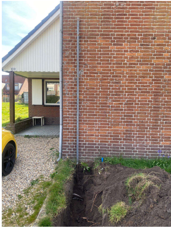
Ontluchtingspijp met septicetank
