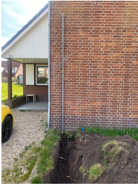
Ontluchtingspijp met septic tank
